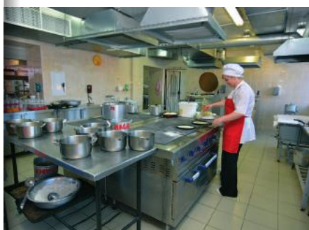
Новое оборудование для пищеблока лицея
